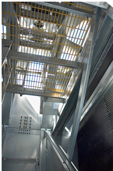
Plataforma de acceso del equipo mecánico
